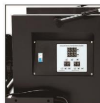
Control panel 控制面板
